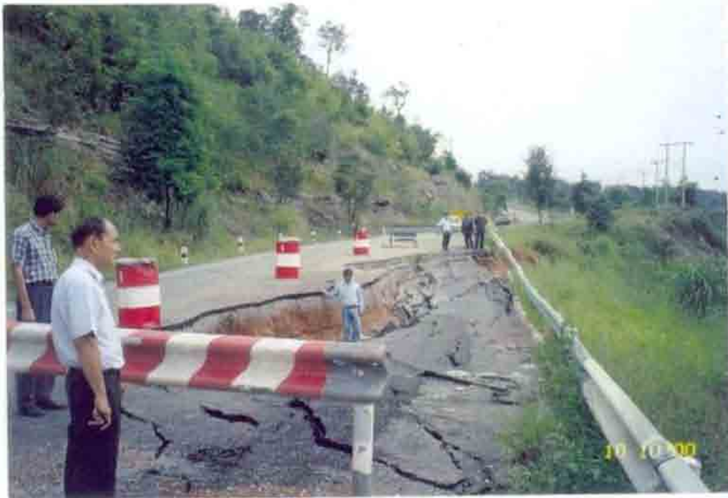
ความเสียหายของคันทางอันเกิดจากน้ำใต้ดิน ทางหลวงหมายเลข 225 ตอน กี่วเขา - วังคะ กม. 109 - 908 - กม. 109 +950 RT.
