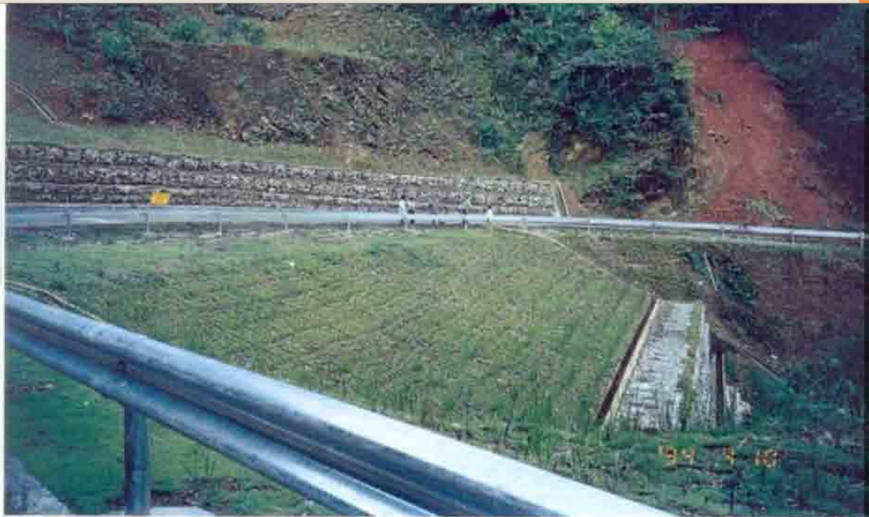
Gabion Retaining wall พร้อมระบบระบายน้ำที่สมบูรณ์ , Stepped Drain chute , Interceptor Subdrain , และปลูกหญ้าแฝก ทางหลวงหมายเลข 1267 ตอน แยกทางหลวง 105 ( อ.ท่าสองยาง ) - กม. 35 + 000 , กม. 17 +050 - กม. 17 +300 , ก่อสร้างแล้วเสร็จ
