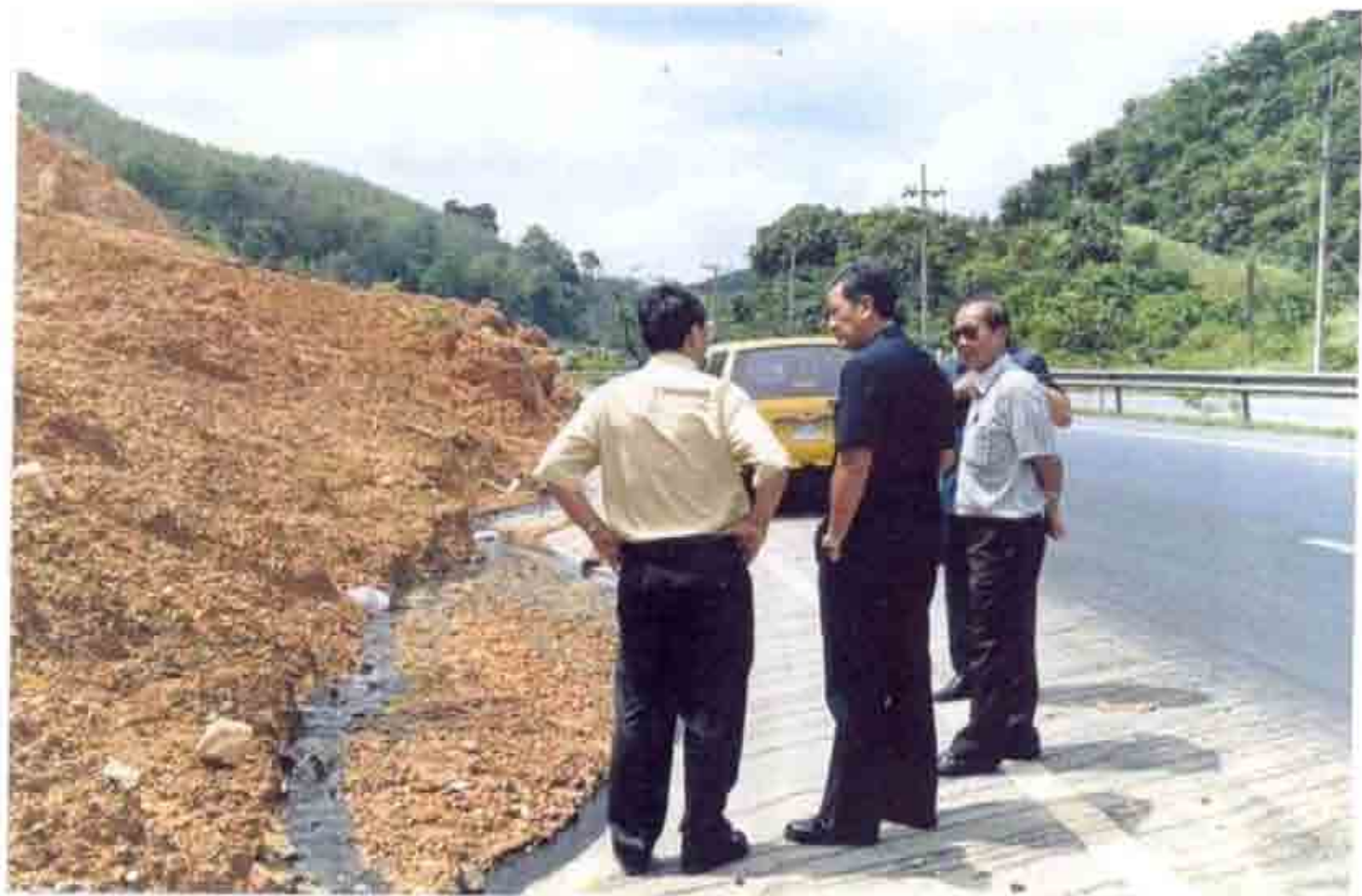
ทางหลวงหมายเลข 41 " อ.ทุ่งสง - พัทลุง " ตอน 1 ความเสียหายของ Back slope กม. 13 +850 - กม. 14 + 025 ( RT. ) อันเกิดจากน้ำผิวดินและน้ำใต้ดิน( ธันวาคม 2543 )
