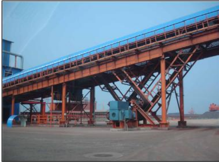
รูปที่ 4-8 สายพานลำเลียงชนิดปิด
