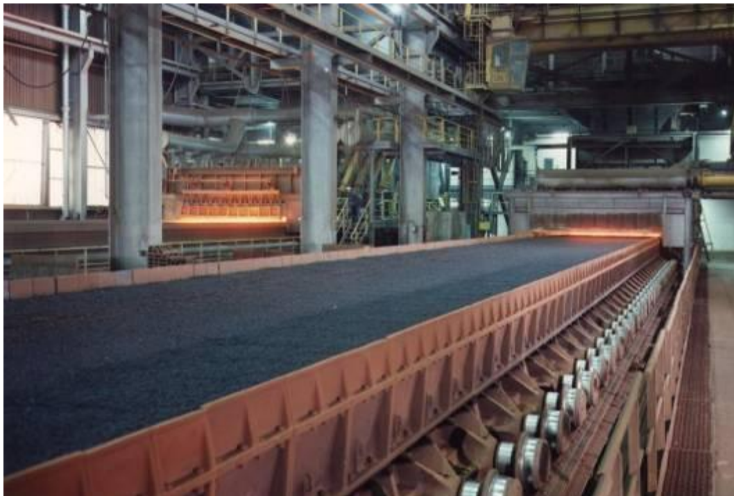
รูปที่ 3-3 รูปถ่าย sinter strand ระบบป้อนวัตถุดิบ และอุปกรณ์ให้ความร้อน (Ignition canopy)
