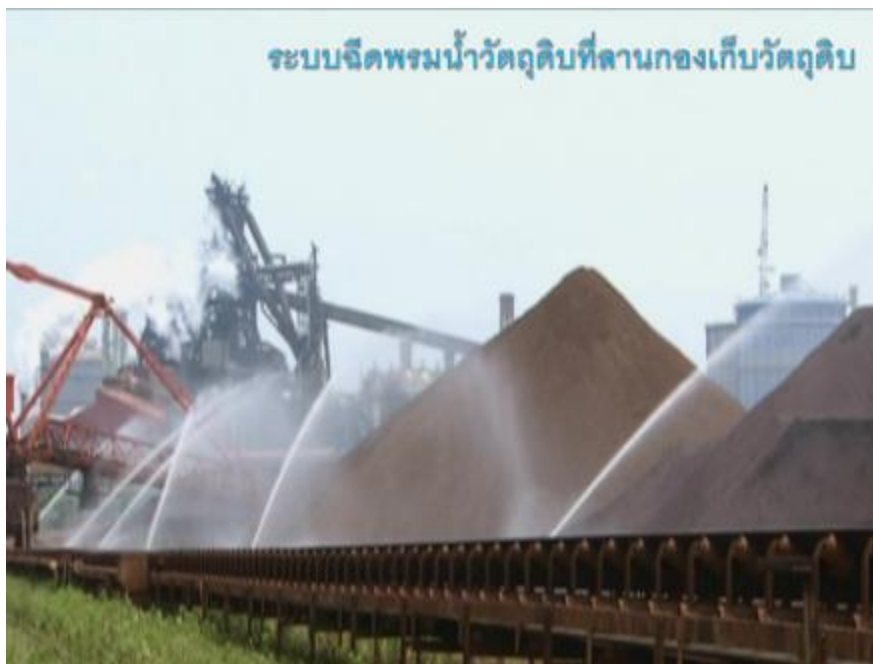
รูปที่ 4-9 ระบบฉีดพรมน้ำวัสดุดิบที่ลานกองเก็บวัสดุดิบ
